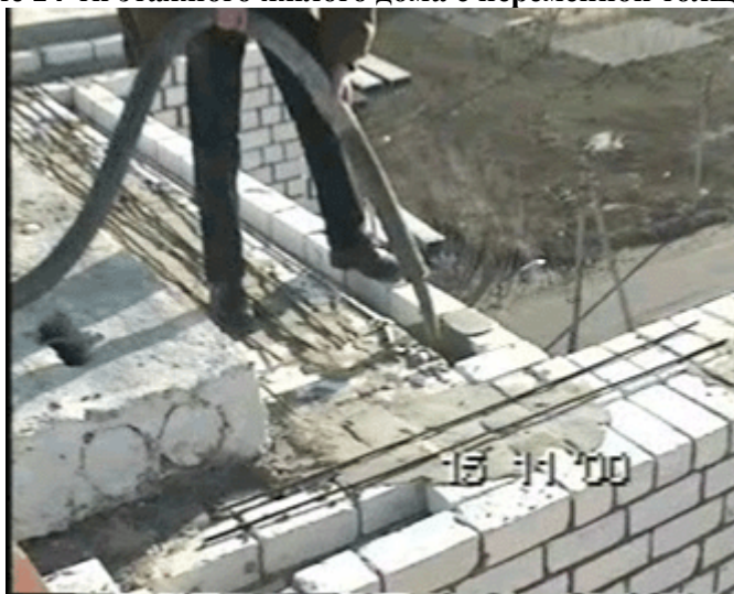
Фот.1 Заливка теплоизоляционного пенобетона плотностью 250 кг/м 3 в колодцевую кладку наружных стен 14-ти этажного жилого дома
